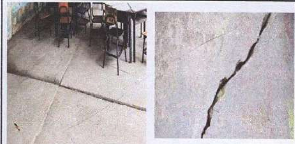
Foto 4: Se necesita sustituir la losa o torta de cemento de un aula y patio porque tiene grietas.
