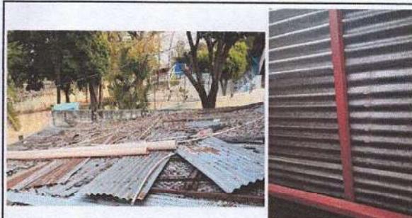
Foto 2: Sustituir techo de lámina oxidada de un aula que tiene goteras por lámina y estructura metálica en techo.
